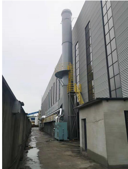
喷漆废气处理设备现场图
