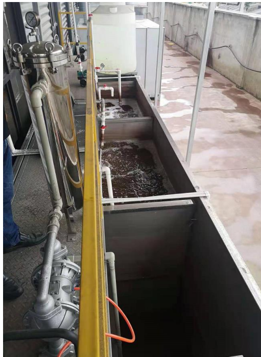
废水处置设施照片
